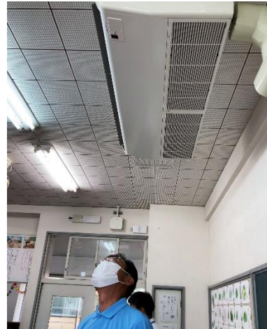
教室内に設置されたクーラー
